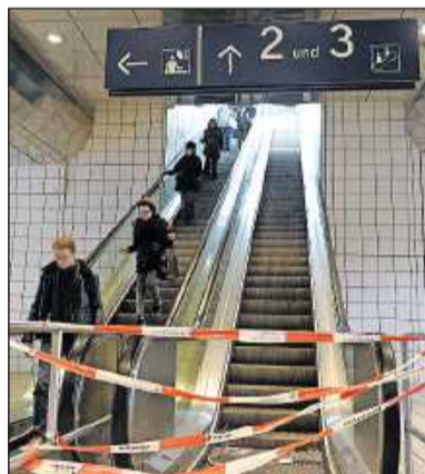
Defekte Rolltreppen am S-Bahnhof Mitte sind ein Dauerärgernis. FOTO: KUNZ
